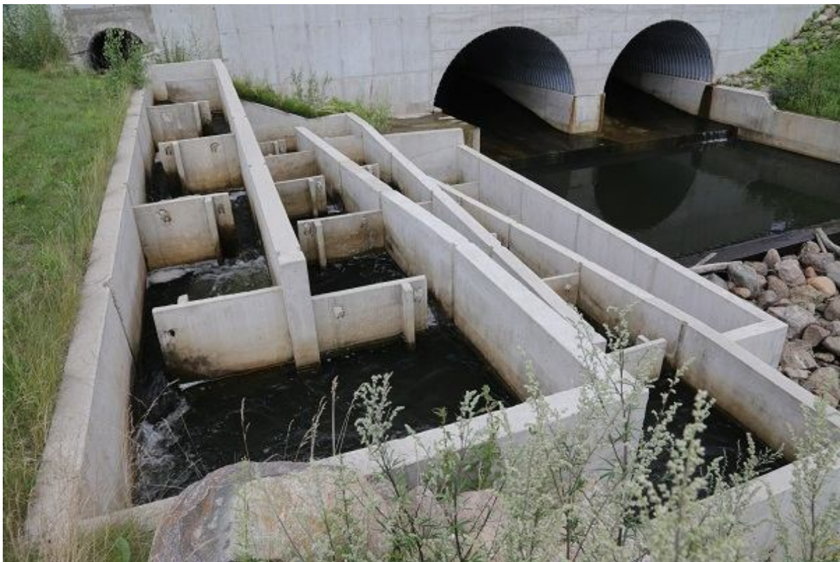
Foto 1.2.14.1. Vaade Sangaste kalapääsule ja liigveelasu äravoolutruupidele alavee poolt. Fotol vasakul ülal on näha paisu läbiv ihtüodukti truur (23.07.2015, R. Järvekülg).
