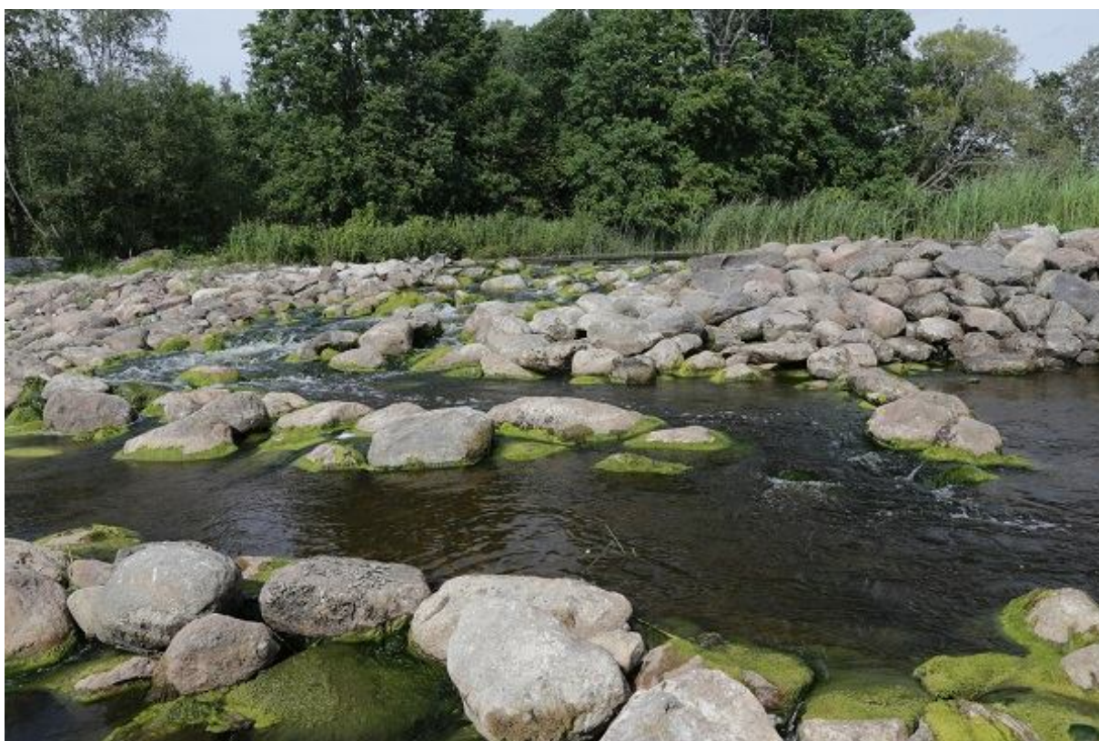
Foto 1.2.17.5. Probleemne koht on kalapääsu ülaosa, eelkõige sissevool ja esimesed 10 m ülavee poolt, mille jooksul veetase kalapääsus langeb >1,0 m võrra (lang >10\% ). Väga suur lang on silmaga eristatav iga nurga alt vaadates (27. 08.2015, R. Järvekülg).
