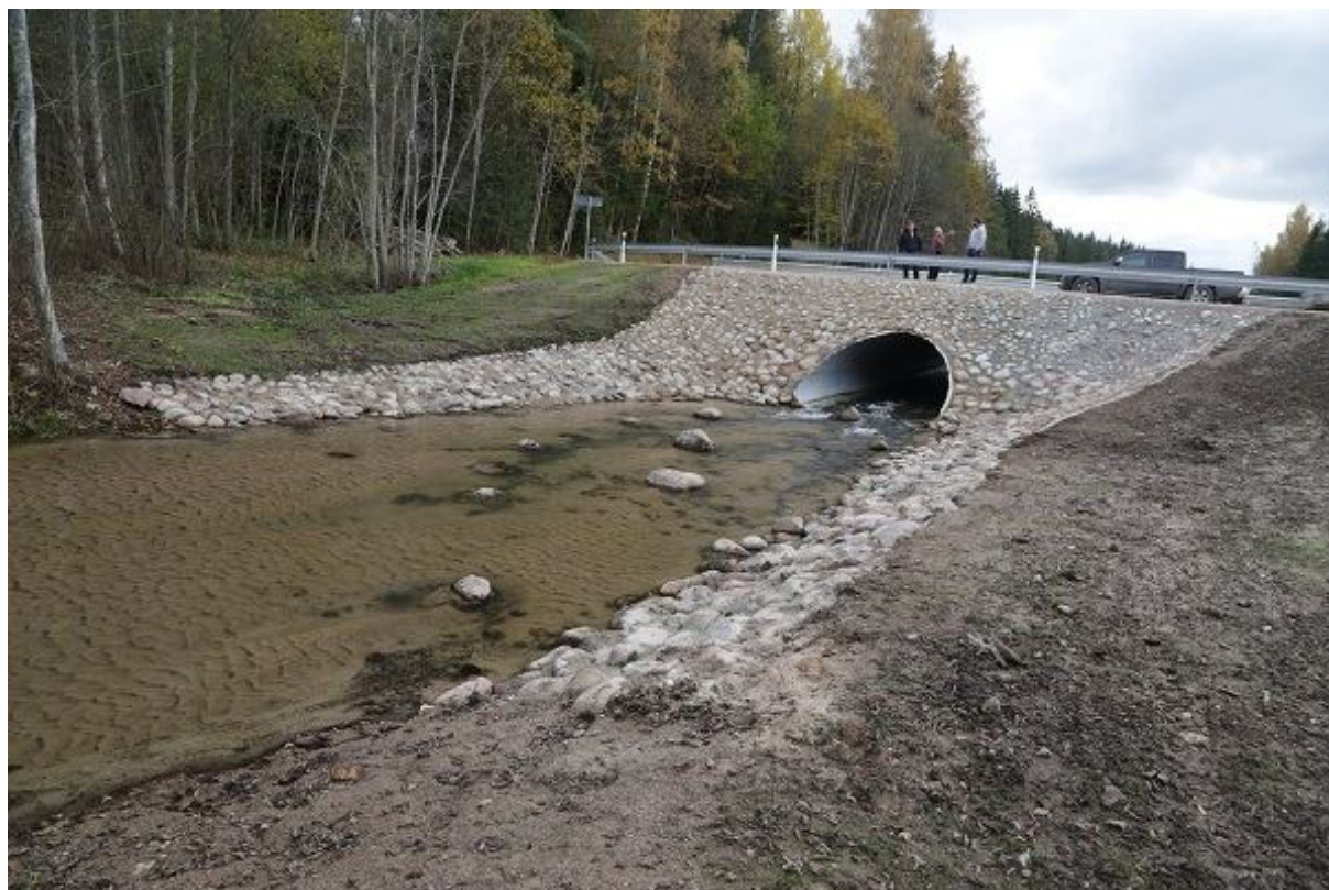
Foto 1.2.5.2. Möksi kalapääsu alaveepoolne osa allpool Kiuma-Peraküla tee truupi (19.10.2015, R. Järvekülg).
