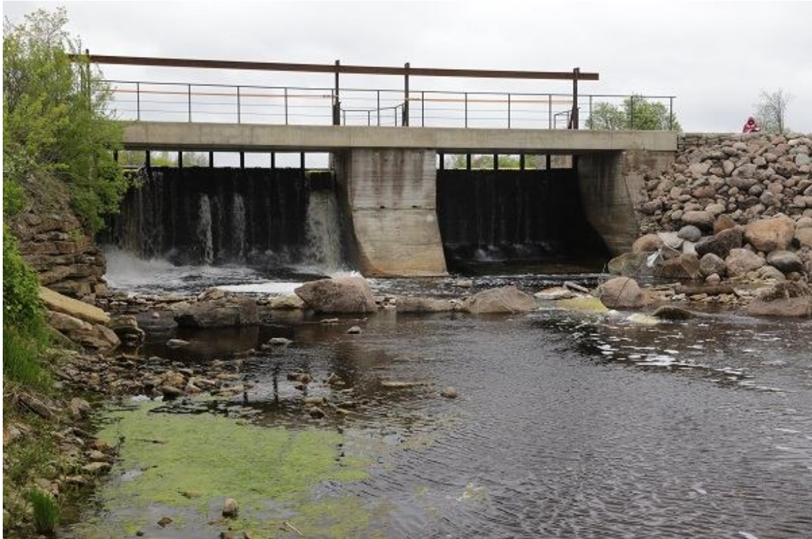
Foto 1.2.13.15. Kalade laskumist liigveelasu kaudu tuleb pidada suhteliselt ohutuks. Kuigi liigveelasu aluse kattis valdavalt minimaalse veetäitega betoonplaat, oli liigveelask avatud põhiliselt servadest ning servade juures oli ka liigveelasu varjade all kitsas veetäitega kanal. Seega kukkus enamik liigveelasult laskuvaid kalu mitte betoonplaadile vaid 0,2...0,3 m veetäitega kanalisse (23.05.2015, R. Järvekülg).
