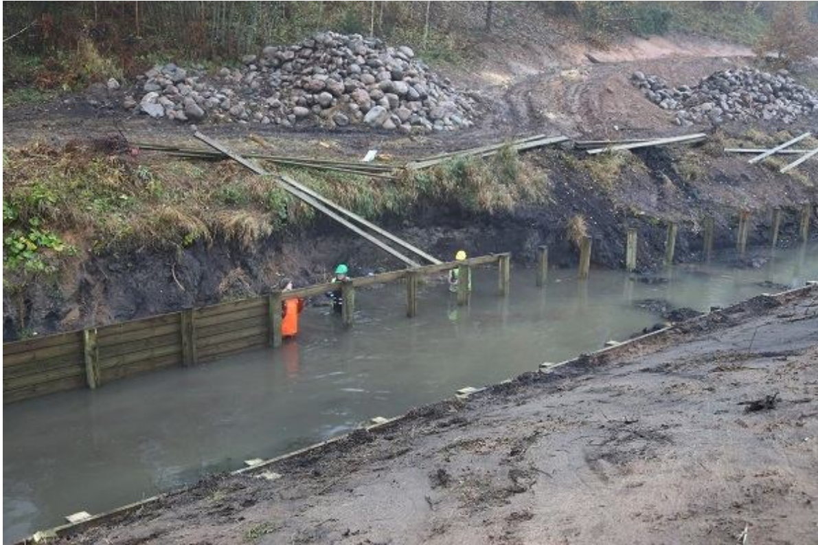
Foto 1.2.15.11. Tsüdsina kalapääsu rekonstrueerimistööd 2014. a. Kallastel on näha ulatuslikud erosioonikahjustused. Kalapääs tuli rajada settelisse pinnasesse, kus on äärmiselt suur oht kallaste ja põhja erosiooniks. See seletab, miks enamikus kalapääsust tuli kaldad laudisega kindlustada (10.10.2014, R. Järvekülg).
