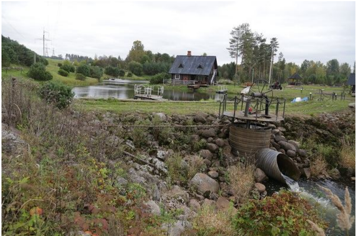
Foto 1.2.11.3. Ploomi paisu liigveelask, tagaplaanil paisjärv. Torukonstruksioon liigveelasul on algselt rajatud HEJ turbiini paigutamiseks. Praeguseks on omanik leppinud mõttega, et HEJ rajada tõenäoliselt ei õnnestu (01.10.2015, R. Järvekülg).
