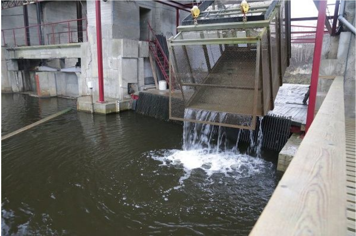
Foto 1.2.7.5. Kalalifti tühendamine ülavette. Lift tühjendatakse 1,5...2,5 m kaugusele hüdroelektrijaama turbiinide sissevoolu võrest (17.11.2015, R. Järvekülg).
