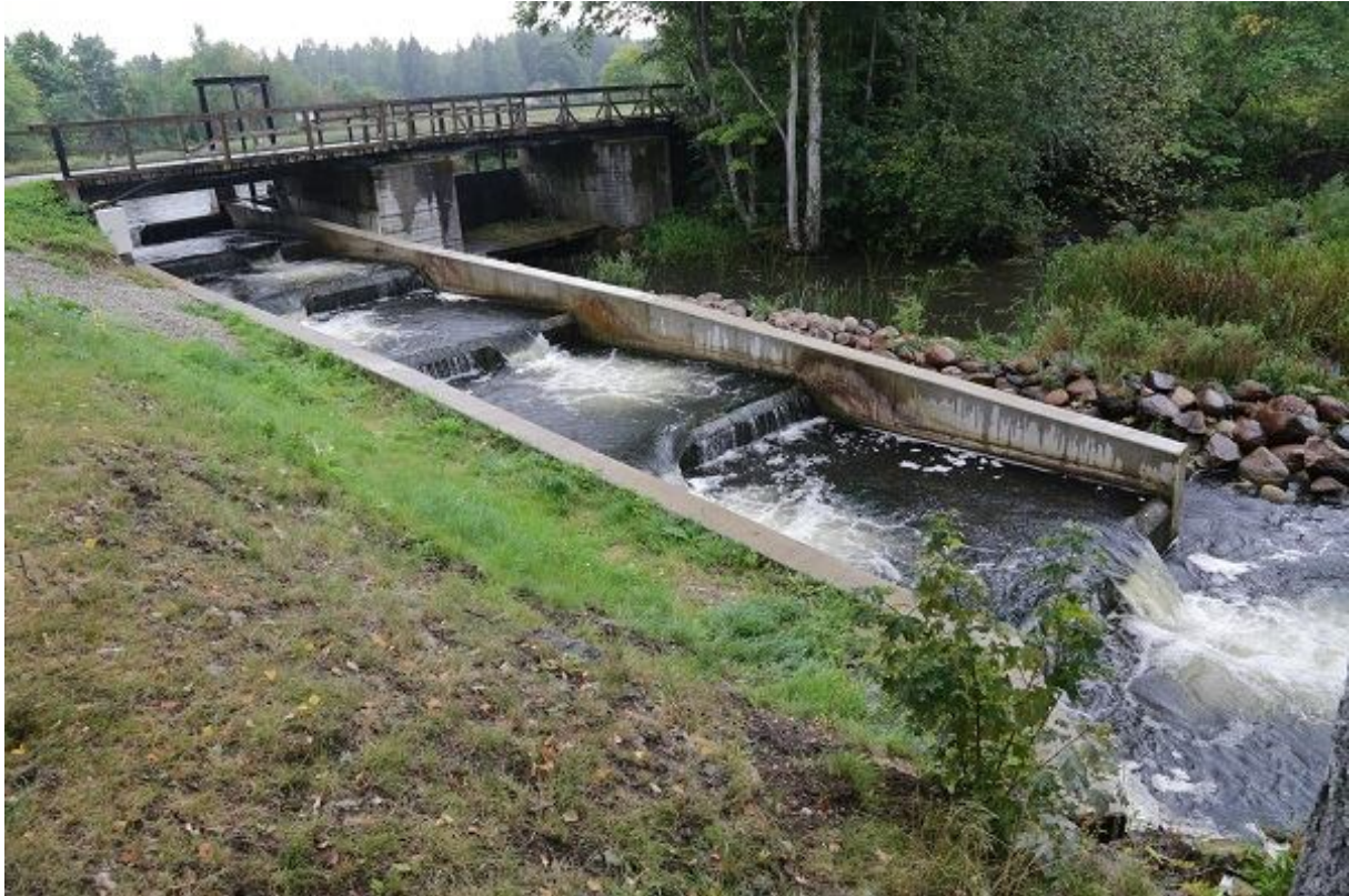
Foto 1.2.10.1. Joaveski kalapääs on tüübilt pinnaavadega kamberkalapääs. Pääs asub jõe parema kalda ääres ning on rajatud liigveelasu ja silla paremasse avasse (26.08.2015, R. Järvekülg).
