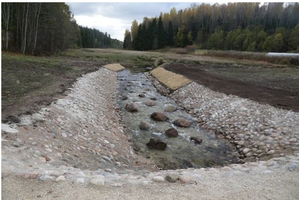
Foto 1.2.5.1. Möksi kalapääsu ülemine osa, Kiuma–Peraküla tee truubist ülesvoolu (19.10.2015, R. Järvekülg).
