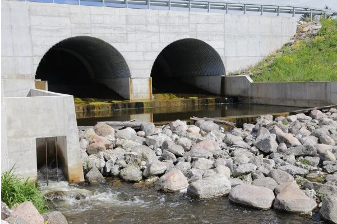
Foto 1.2.14.5. Kalapääsu väljavool. Alavee täide kalapääsu väljavoolu juures on vähemalt 0,4 m madalamal kui see olema peaks. Selline kalapääsu väljavool koos liigveelasul voolu puudumisega ei kutsu kevadrändel olevaid kalu pääsu sisenema (22.05.2015, R. Järvekülg).
