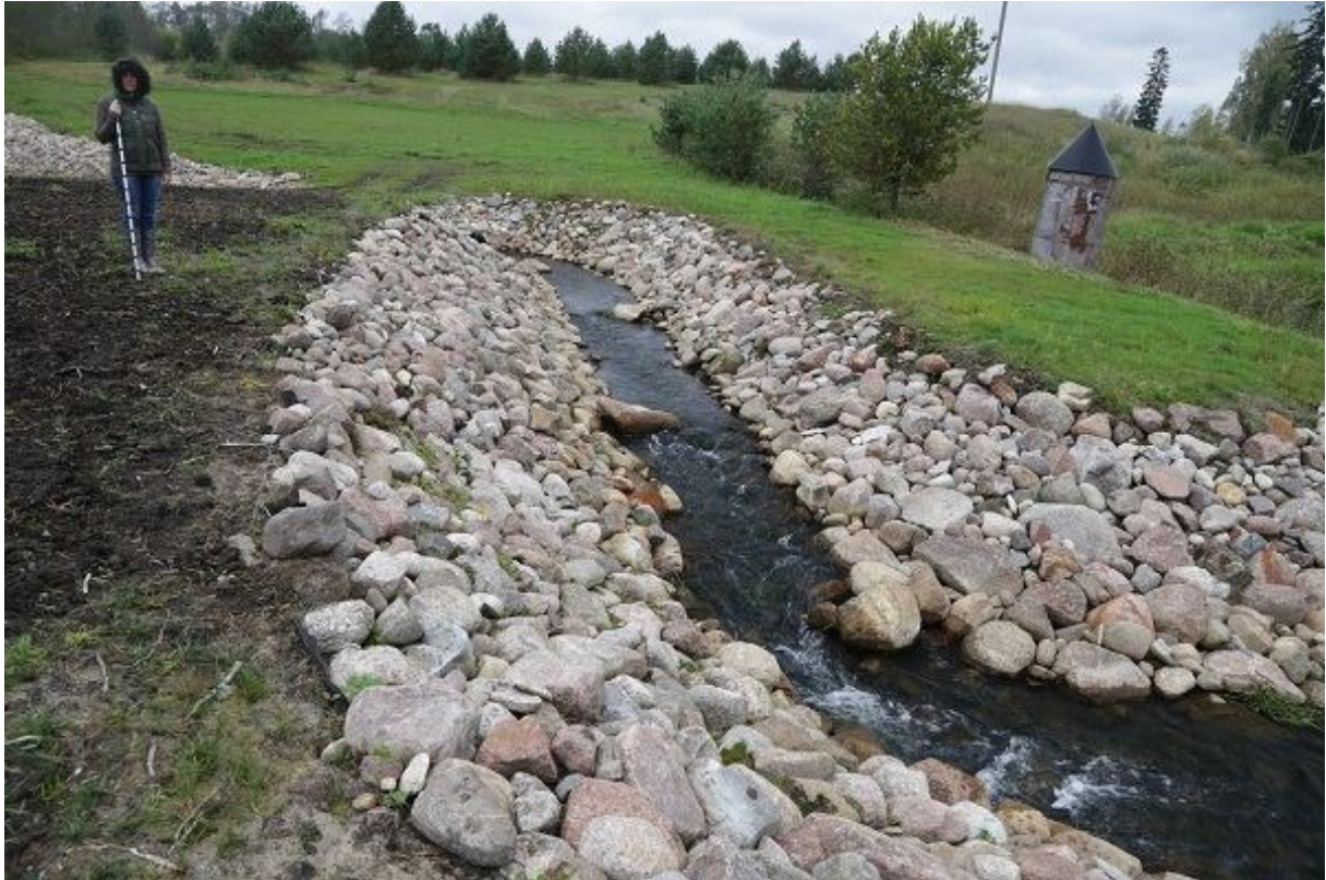
Foto 1.2.11.5. Kalapääsu alumine osa. Voolurahustuskive võiks olla 3 korda rohkem. See muudaks kalapääsu kaladele kergemini läbitavaks suurte vooluhulkade korral ning parandaks kalapääsu elupaigalist väärtust (01.10.2015, R. Järvekülg).
