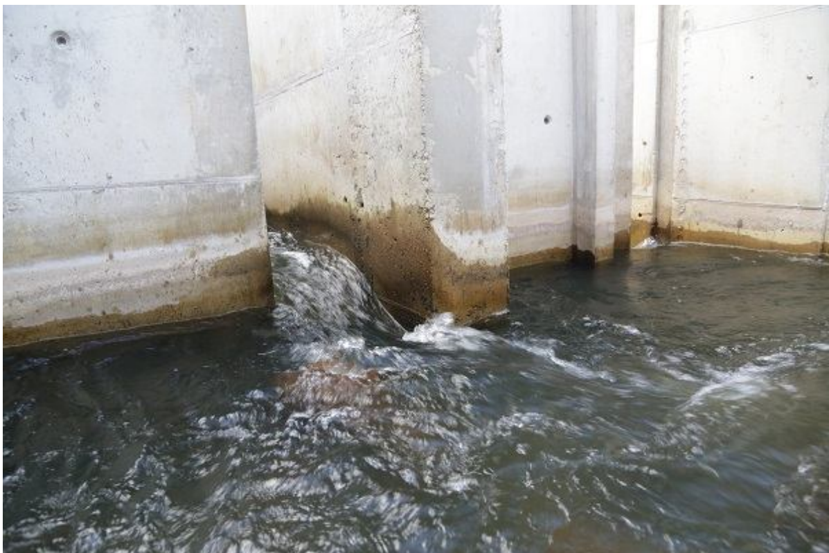
Foto 1.2.12.5. Veetasemete vahed kambrite vahel pidid projekti järgi olema 0,11 m, tegelikult varieerus veetasemete vahe piirides 0,05...0,25 m. Põhjus – osa kambreid ja läbivooluavasid oli risuga ummistunud. Kamberkalapääs vajab pidevat hooldust. Fotol alumine pöördkamber, kus veetasemete vahe sissevoolul oli 0,15 m (03.08.2015, R. Järvekülg).
