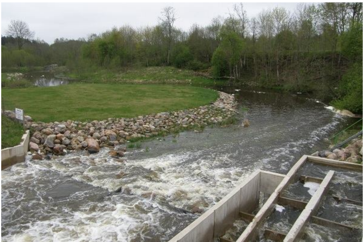
Foto 1.2.14.8. Sellise vooluhulgaga on kaladel motivatsioon paisu alla tõusemiseks. Samas on alavee tase kalapääsu juures ka siis liiga madal ning kaladel kalapääsu sisenemine raske (vt veetase viimases kambris ja kalapääsu väljavoolul) (08.05.2015, R. Pihu).
