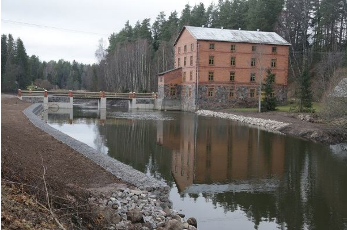
Foto 1.2.6.1. Ahja jõgi Kiidjärvel pärast paisu likvideerimist, silla renoveerimist ja jõe kaldaalade korrastamist. 6 km allavoolu asuva Saesaare paisu paisutus ulatub üsna täpselt vana Kiidjärve veskihooneni (R. Järvekülg).
