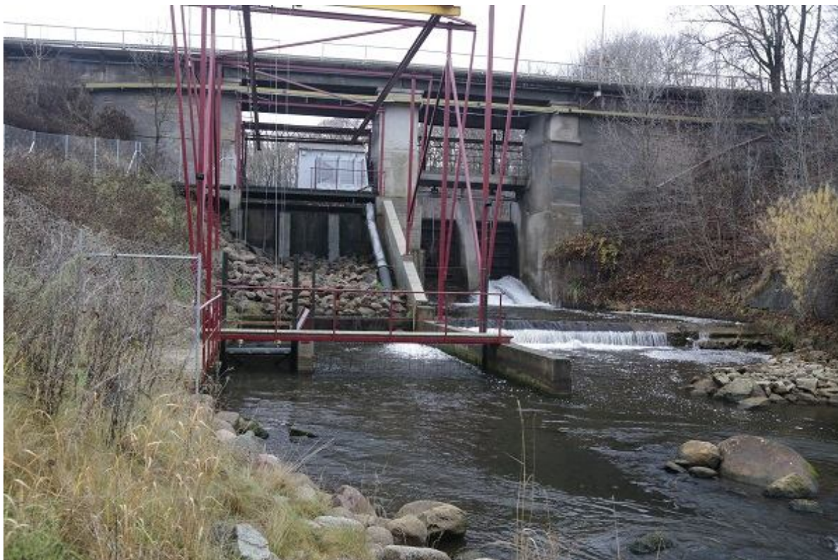
Foto 1.2.7.2. Kunda kalalifti konstruksioonid alavee poolt vaadates, lift on alavees uputatud olekus (14.11.2015, R. Järvekül).
