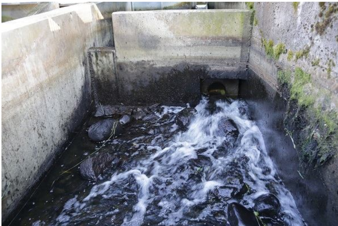
Foto 1.2.9.7. Kalapääs on projekteerija poolt selgelt üle-dimensioneeritud. Selleks, et kalapääs enamiku aastast „kuiv“ poleks on kalapääsu omanik püüdnud läbivoolu põhjaavadest vähendada. Selleks on 40 x 40 cm põhjaavade ette kinnitatud plekktahvlid avadega d=0,19 m (25.08.2015, R. Järvekülg).
