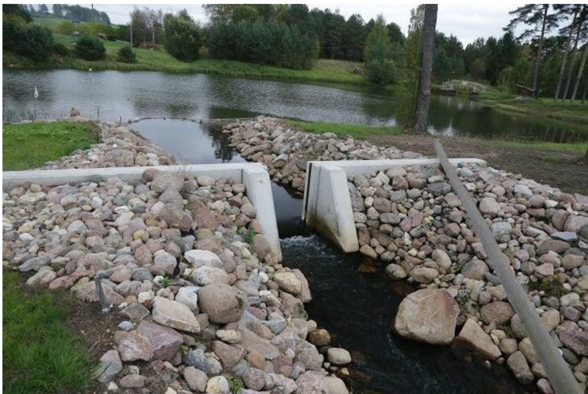
Foto 1.2.11.8. Kalapääsu sissevoolul on regulaator, mida on võimalik varjadega sulgeda. Et väheveelisel ajal hoida paisjärve maksimaalset veetaset, on omanik regulaatori ava osaliselt varjadega sulgenud. Kalapääsu sissevoolu on näha mõrd. Mõrrapüügid toimusid kevadel 22.04.-03.06. ja sügisel 25.09.-25.11.2015 (01.10.2015, R. Järvekülg).
