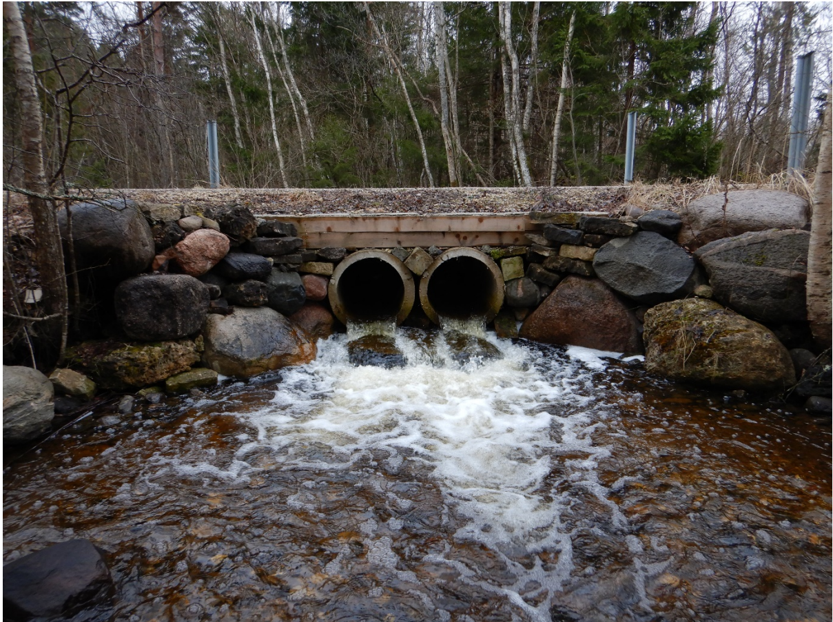
Foto 20. Virita-Läägi külateelteil paiknev betoontorudest binokkeltruup (nõ Läägi truup) on ülesvoolu rändel enamikule vee-elustikust ületamatuks takistuseks. Truubi väljavoolu alla on erosiooni takistamiseks paigutatud suured kivid (Imre Taal, 14.04.2022).
