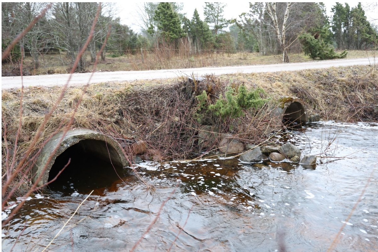
Foto VKK6. Riksu jõe alamjooksul paiknev truup (15.02.2023). Riksu lahe ja mere vahel paiknev truup on vee-elustikule läbitav (Markus Vetemaa).
