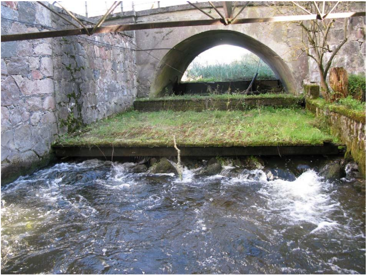
Foto 1.11. Undla pais on väga halvas tehnilises seisus. Kogu vesi voolab läbi paisu laudise aluste konstruktsioonide (M. Kesler).
