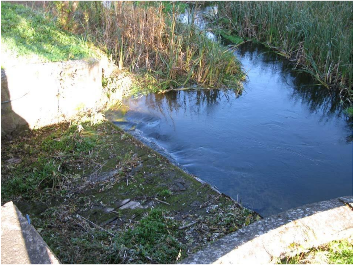
Foto 1.12. Esiplaani on Undla paisu ülemise osa. Vesi on rajanud omale tee läbi paisu laudise aluste konstruktsioonide. Paisjärve veetase on selle tulemusena hakanud alanema (M. Kesler).
