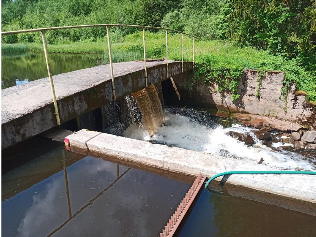
Foto Raudsilla 2. Esiplaanil hej sissevoolukanal, tagaplaanil paisu liigveelask (09.06.2022).
