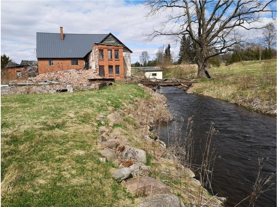
Foto Sangaste 1. Veskihoone (vasakul) ja hej hoone (väike valge paremal) ja hej äravoolukanal (28.04.2022).
