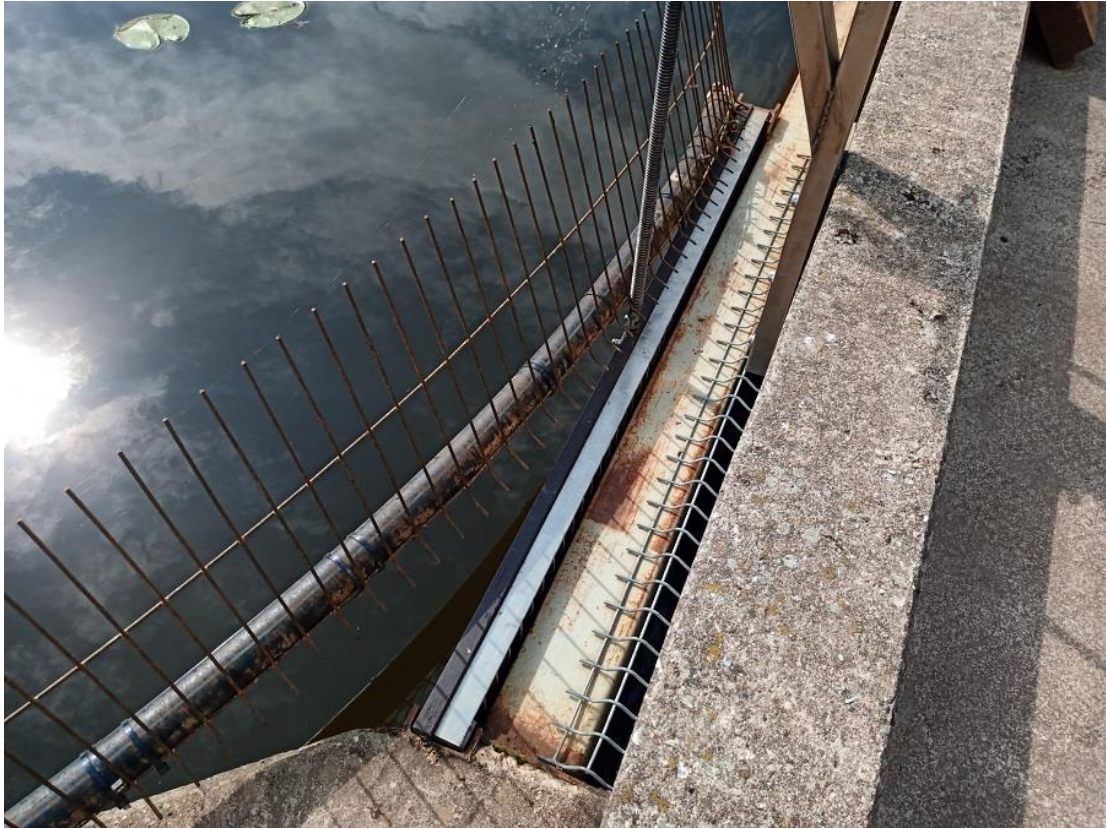
Foto Elva (Räbi) 3. Võre turbiinikanali sissevoolul oli vaatluspäeval avadega 32 mm (10.06.2022).
