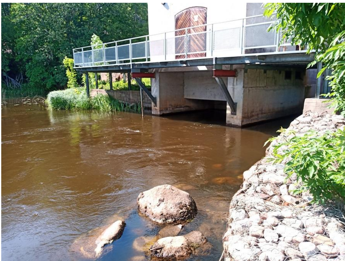
Foto Rápina 7. Rápina paisjärve tühjenduskanalil asuva hej turbiini väljavool (09.06.2022).
