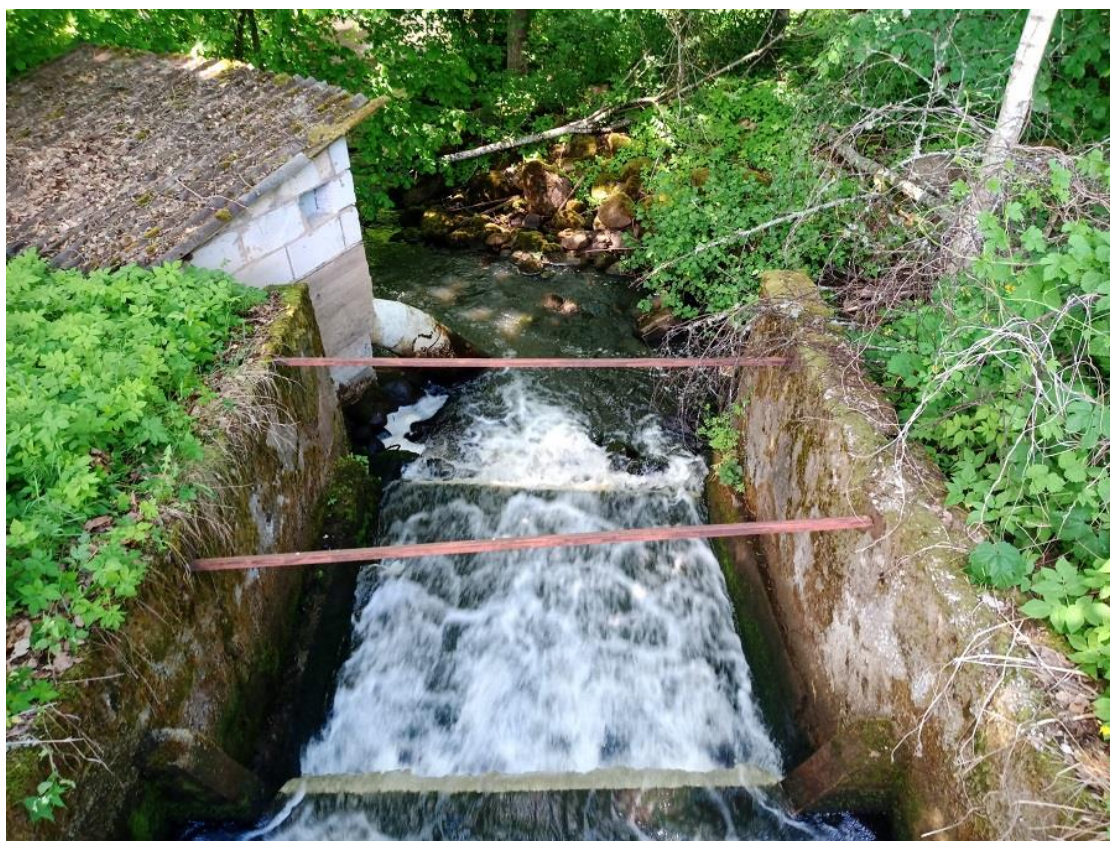
Foto Peri 3. Hej hoone just ehitusliku šedöövri moodi välja ei näe. Õnneks on ta liigveelasu konstruktsioonidest ja puudest hästi varjatud (09.06.2022).
