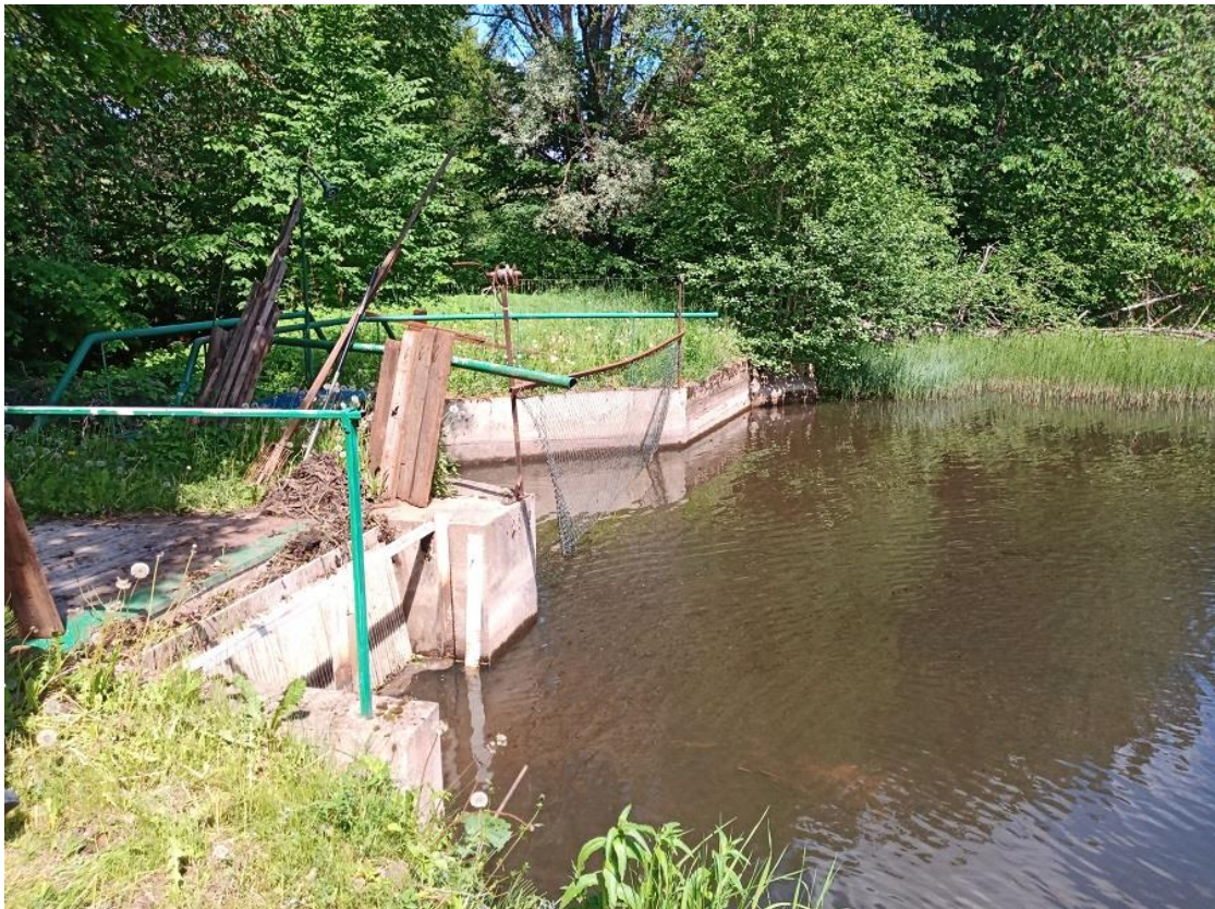
Foto Peri 1. Peri paisu ligveelase on ehituslikult halvas seisukorras (09.06.2022).
