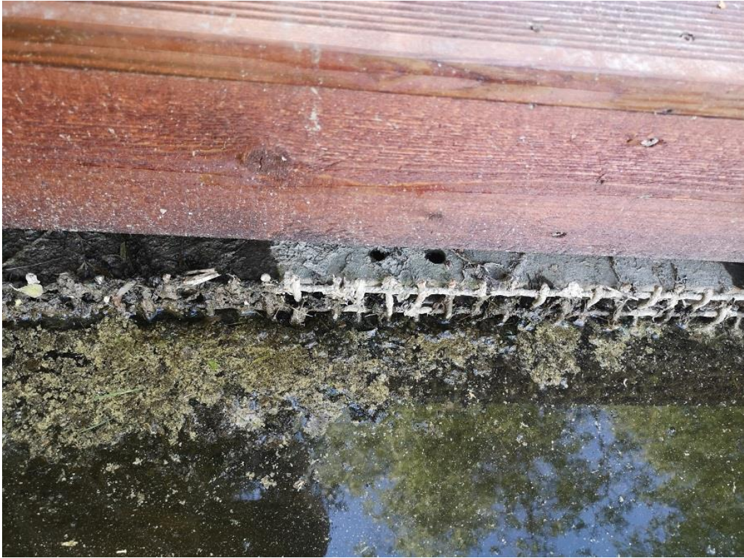
Foto Ala-Rõuge 5. Põhiturbiini sissevoolukanali ees olev võre avadega 19...20 mm (07.06.2022).
