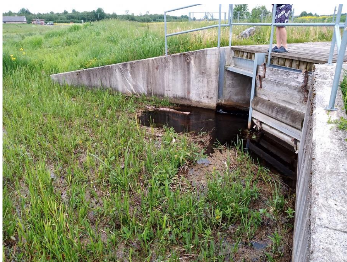
Foto Kamari 6. Kamari II paisu kalapääsu sissevool oli ummistunud ja vajab puhastamist risust (14.06.2022).
