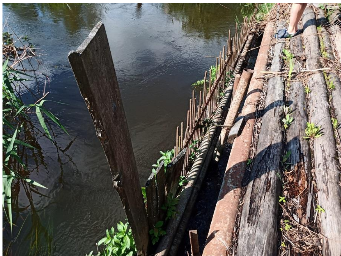
Foto Paidra-3. Paidra hej turbiinikanali sissevoolul olev võre on deformeerunud, suurte avadega ja vajab asendamist (09.06.2022).
