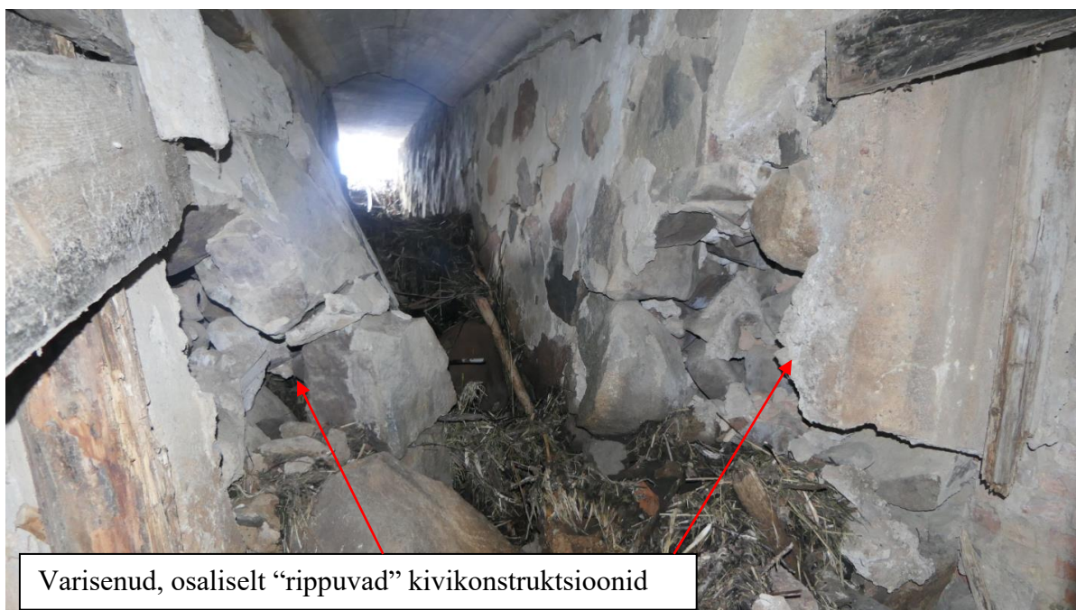
Foto 12. Veskikanal, vaade turbiinikambrist ülesvoolu (30.04.2020)
