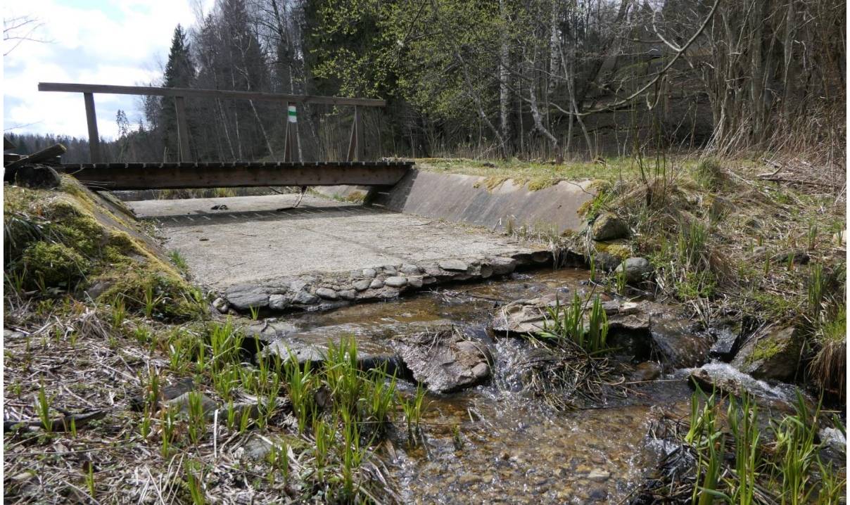
Foto 2. Vaade ülevoolule alavee poolt (30.04.2020). Vesi väljub betoonplaadi alt.
