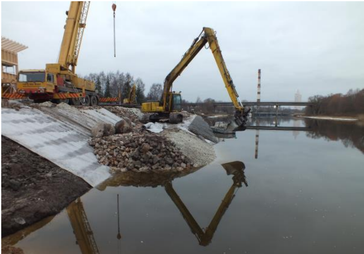
Foto 4. Emajõe süvendamine Karlova paadisadama piirkonnas. Pinnas kaevatakse välja ja veetakse minema. Kallas täidetakse kivimaterjaliga ja kindlustatakse. Kaevetööde piirkonda ei ole heljumi leviku tõkestamiseks piiratud. (M.Viirma foto 2014).
