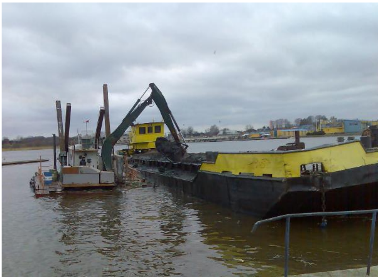
Foto 1. Pärnu jõe süvendamine Pärnu jahisadama piirkonnas. Pinnas kaevatakse välja ujuvsüvendajaga, laaditakse praamile ja veetakse minema (asukoht teadmata). Kaevetööde piirkonda ei ole heljumi leviku tõkestamiseks piiratud. (M.Viirma foto 2018).
