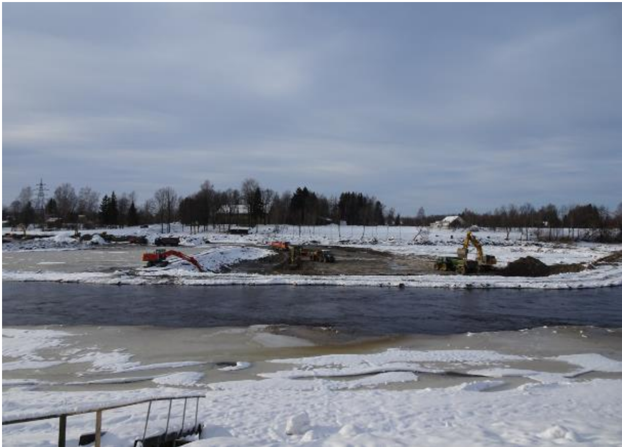
Foto 2. Pärnu jõe süvendamine Sindi väliujula piirkonnas. Pinnas kaevatakse välja kuival maal paiknevate lintekskavaatoritega. Väljakaevatav materjal laaditakse veoautodele ja veetakse kalda täiteks endise paisjärve alal. Kaevetööde piirkond on eelnevalt piiratud pinnastammidega. Heljumi levik toimus ainult tammide paigaldamise ja tammide eemaldamise ajal. (R. Ariko foto 2019).
