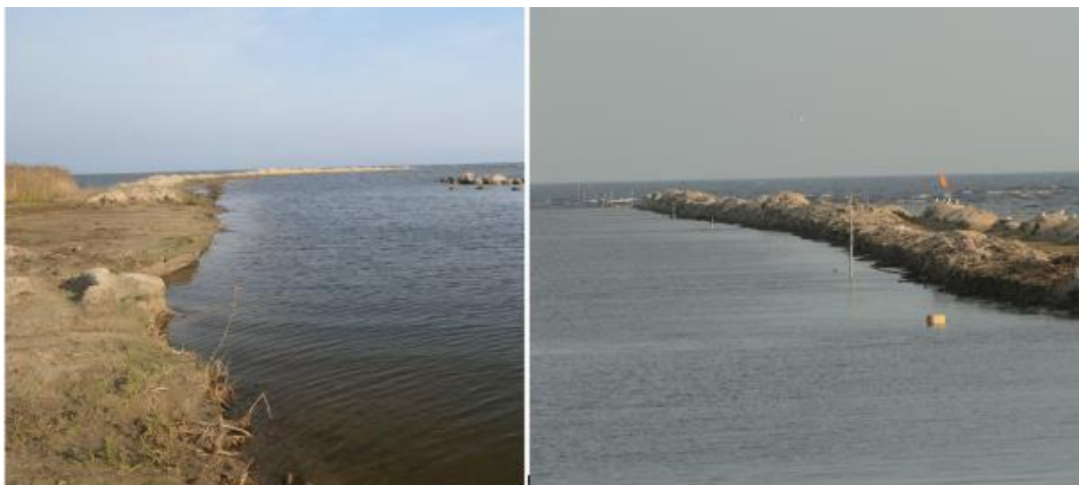
Foto 5. Kolkja (vasakul) ja Varnja (paremal) sadama sissesõidutee puhastamine Peipsi järves. Väljakaevatud materjal paigutati järve. Pinnas kaevati välja kaevatud pinnasest moodustatud vallil sõitnud ekskavaatoriga. Kaevetööde ja materjali ladustamise piirkonda ei ole heljumi leviku tõkestamiseks piiratud, (M.Viirma foto 2019).
