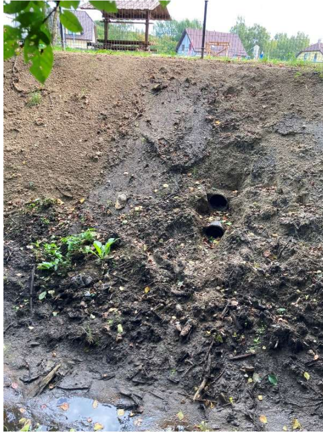
Foto 13. Vanapere tee äärse uusarendus-piirkonna kohal registreeriti krundi pinnasega täitmisest tulenev ülemäärane kaldaerosioon ning mõned ebaselge otstarbega peakraavi suubuvad (vaatlushetkel kuivad) toruotsad (P. Pall, 8.08.2024).
