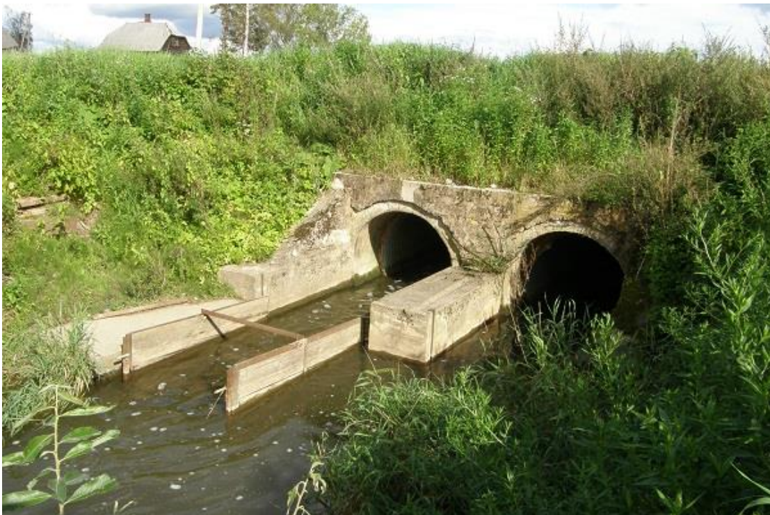
Foto 2.3.8. Toku pais on konstruktsiooniliselt seotud Alakiisa–Tiidu–Tsiksi teetruubiga. Vaade Toku paisu äravoolule alavee poolt (R. Pihu, 02.09.2016).
