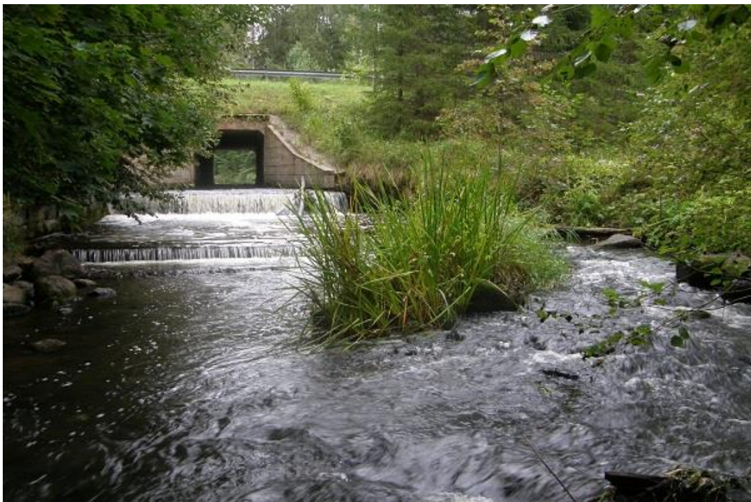
Foto 2.1.18. Märdi külas Sihva–Risttee maanteest (80,97 km suudmest) vahetult allavoolu on silla ehitamisega seoses loodud jõele kaheastmeline betoonastang summaarse paisutuskõrgusega 1,2 m (R. Pihu, 04.09.2017).
