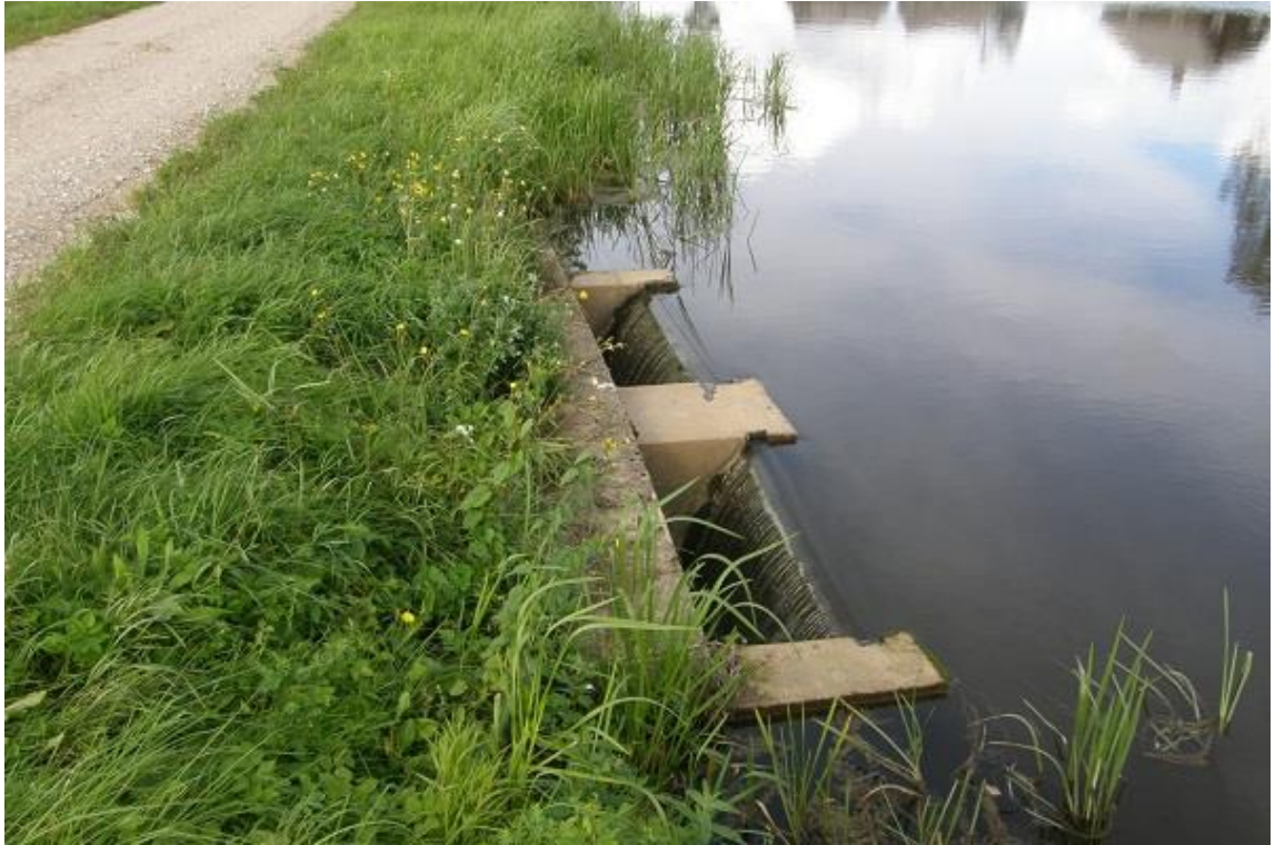
Foto 2.3.9. Vaade Toku paisule ülavee poolt. Paisu kõrgus on 2,2 m ning see jagab forelli asuala jões kaheks üksteisest püsivalt isoleeritud osaks (R. Pihu, 02.09.2016).
