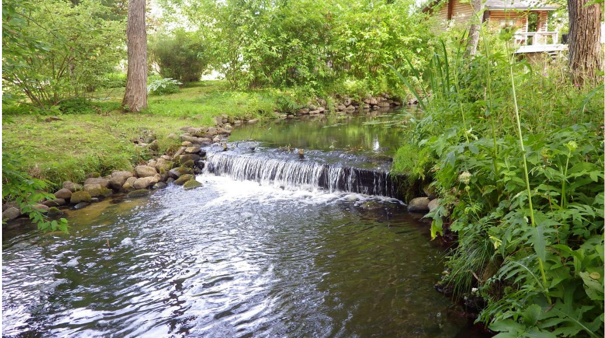
Foto 3.1.7. Priidu talu all olev betoon- ja puitkonstruktsiooniga pais (56,45 km suudmest), millel paisutuskõrgus on 0,5 m.
