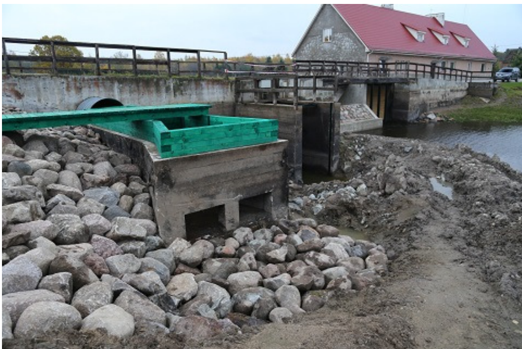
Foto 2. Kalapääsu sissevooluavad. Tagaplaanil on näha turbiini sissevool ja liigveelase (R.Järvekül, 09.10.2013).
