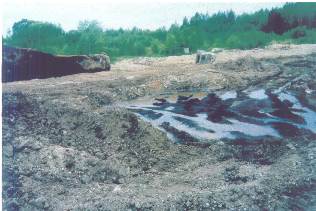
Foto 5. Metallist kütusemahuti põhjade eemaldamisel avanes ca 0,5 - 1,0 m paksune tume ja tugevalt reostunud pinnasekiht. Vasakul on näha eemaldatud metallist mahutipõhi.
