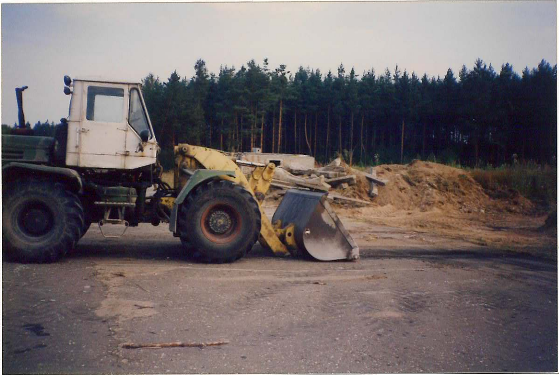
Foto 3. Reostunud pinnase eemaldamiseks tuli eelnevalt kõrvaldada betoonplokid jms. ehituslikud konstruktsioonid, mis paigutati reostuskoha kõrval olevale alale Fotograaf H. Tang. Foto kuupäev 20.08.1997
