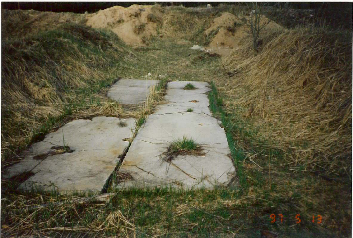
Foto 2. Osaliselt oli reostunud ala kaetud betoonist plaatidega vm. betoonist konstruktsioonidega Fotograaf T. Meriste. Foto kuupäev 13.05.1997
