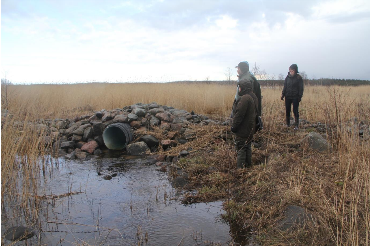
Foto 40. Teorehe kõige põhjapoolsem truup on paigaldatud liiga kõrgele ning ei võimalda madala veeseisu korral kaladel merre laskuda (foto tehtud 16.04.2015).
