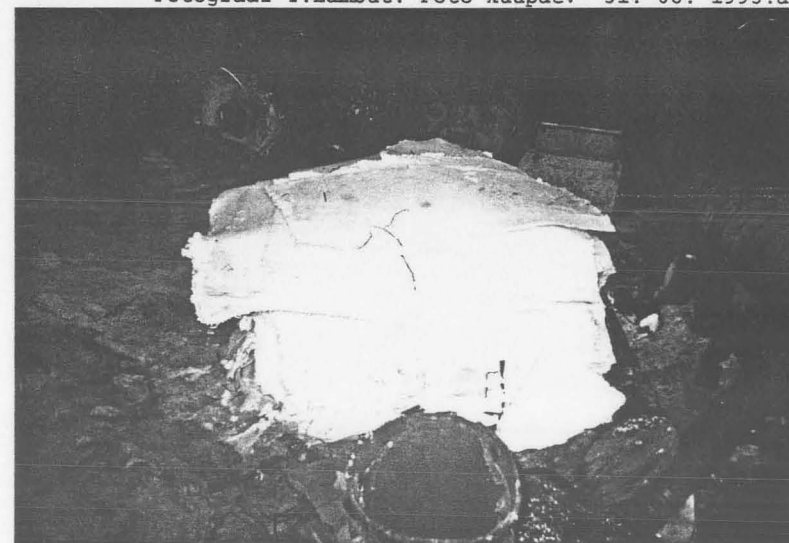
Foto 22. Asbestplaadid (objekt nr. 34) Fotograaf T.Lambut. Foto kuupäev 30. 08. 1995.a.
