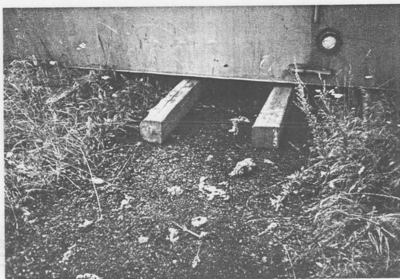
Foto 40. Vaatamata ettevaatusabinõudale reostab lekkiv mahuti pinnast (objekt nr. 53) Fotograaf T.Lambut. Foto kuupäev 29. 08. 1995.a.
