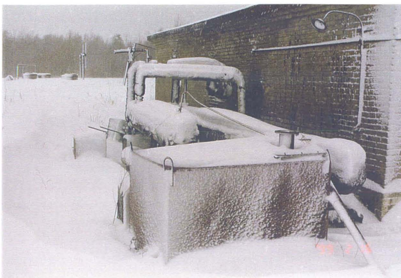
Foto 2. Pumbajaama (nr. 319 A) nurga juuresolev 5 m 3 mahuti ja kondensaator
