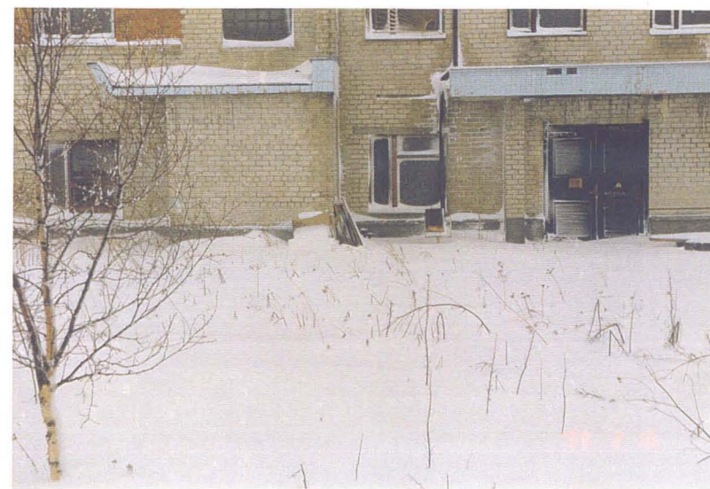
Foto 8. Vaade hoonele nr. 302, kus sadevete kanalisatsioon ja drenaaživee süsteemid ühinevad ühenduskaevus ühtseks kollektoriks
