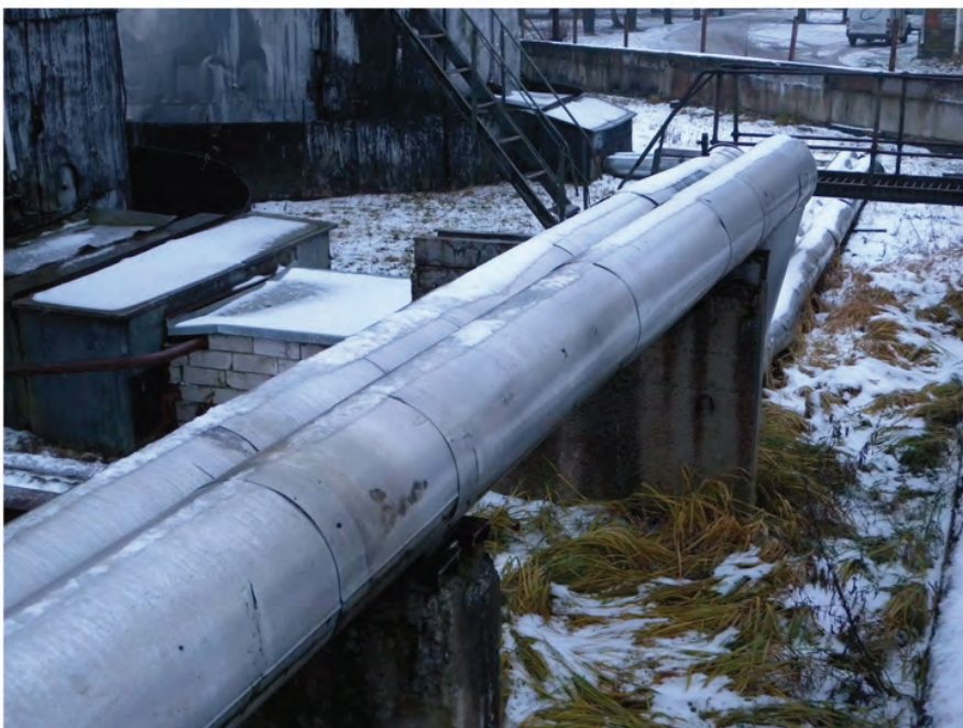
Foto 05 Avoterm OÜ Tööstuse tn 2A mahutid paiknevad betoonkessosoonis.JPG
