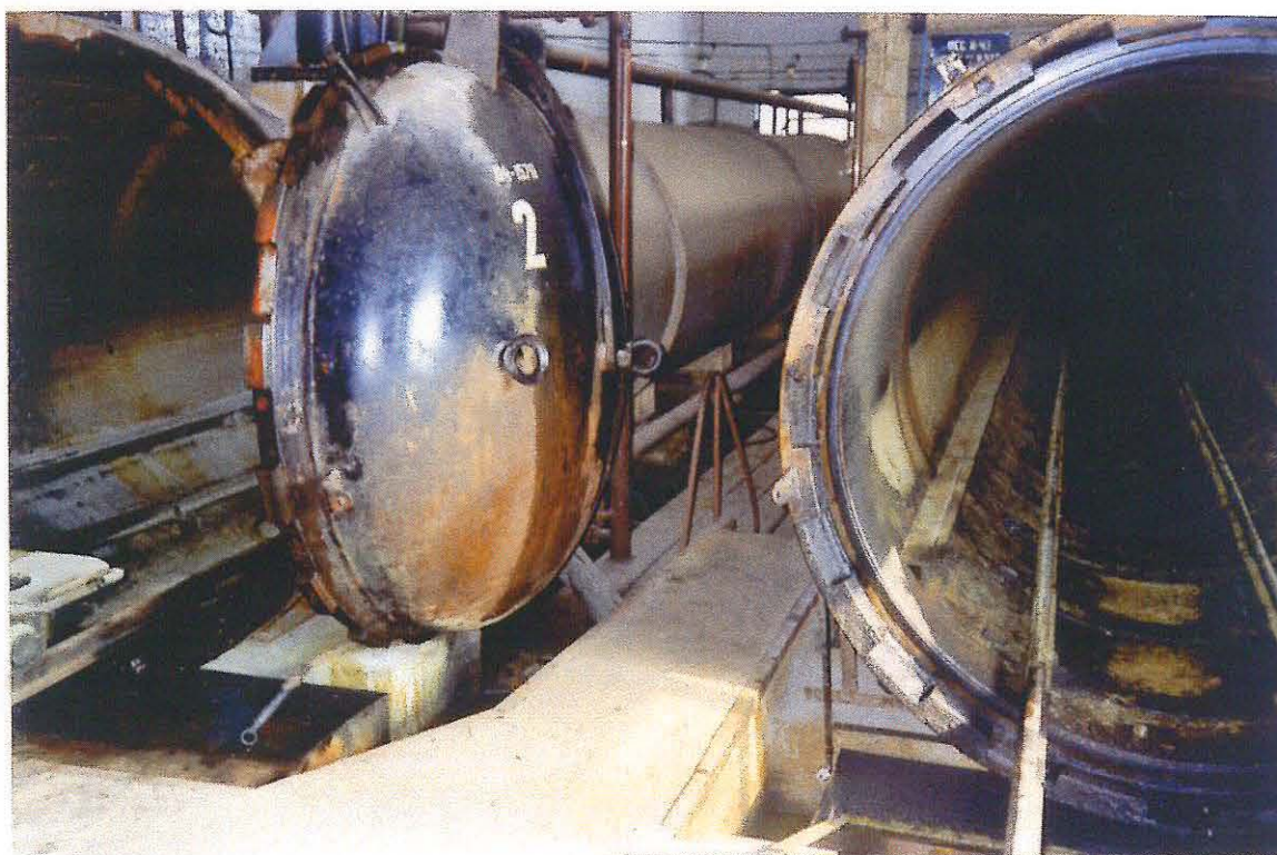
Puiduimmutuse autoklaavid, mille alla asub ca 100m 3 reostunud vett ja setet
