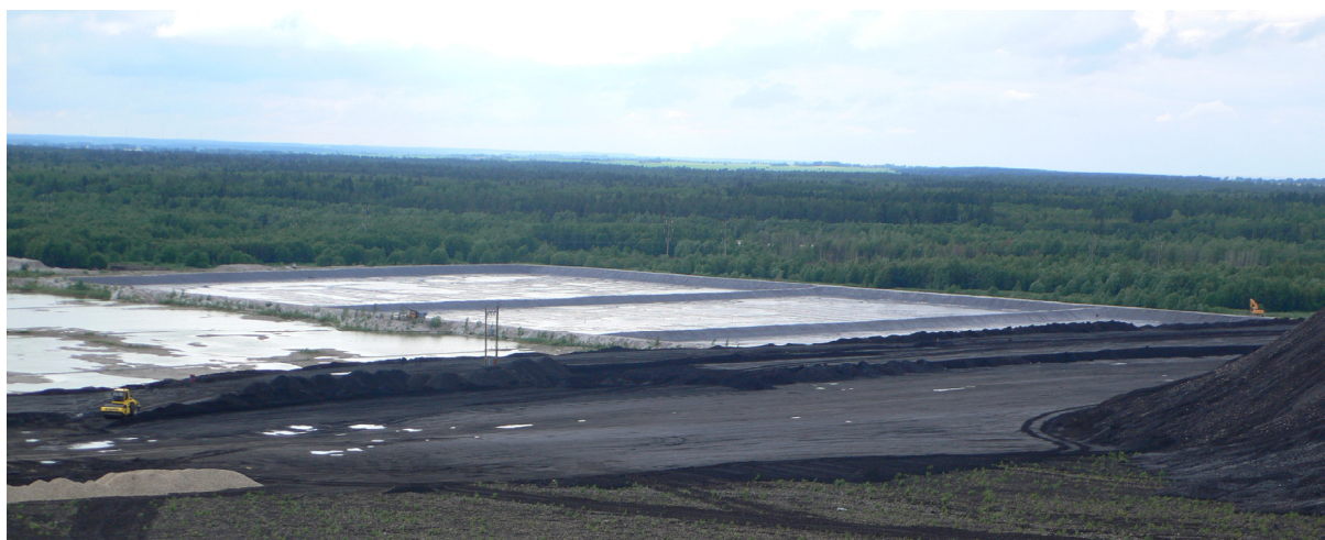
Foto 3 Ülemine mudatiik juunis 2007, uue prügila põhi on rajatud, taamal on uue prügila kilega veekindlaks tehtud sademevee ühtlustusbasseinid
