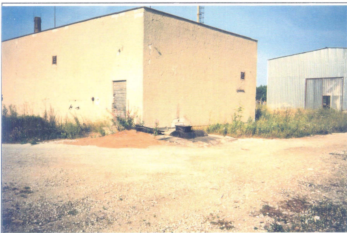
Foto 6-2 Piira katlamaja õlihoidla. Hoone nurga juures on kütuse vastuvõtusõlm. Vahemahutil ja seda ümbritseval betoonil on jälgitav reostuslaik.
