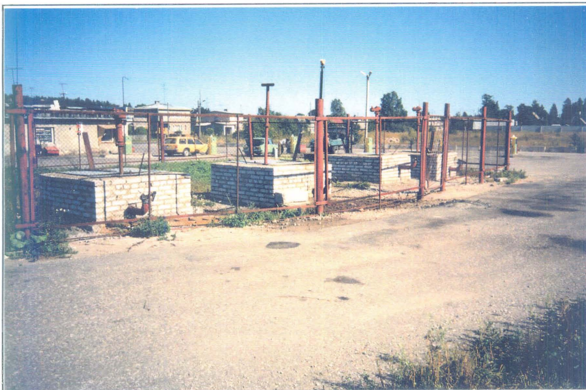
Foto 5-1 Oü Rakvere Autobaasi tankla kütusehoidla. Täitetorude all on näha killustiku värvumine kütusereostuse tõttu.
