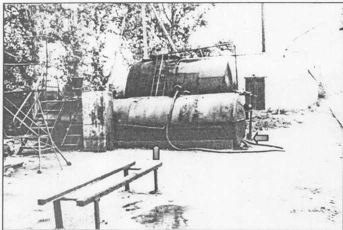
Foto 1. Tallinna veduridepoo läbitõotanud õli 10 m 3 ja 15 m 3 kogumismahutid. Kogumismahutitel puudub avariivann ja ümbritsev pinnas on reostunud naftasaadustega.
