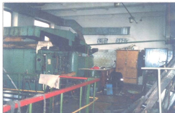
Foto 24. Tartu depoo. Õliseguse sadevee puhasti-flotaator O=33-5
