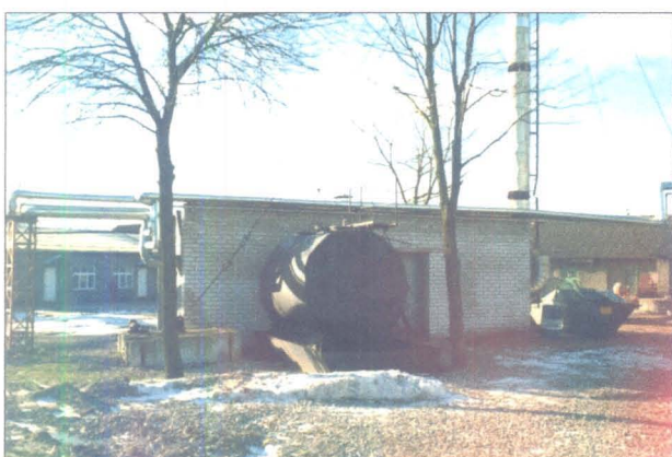
Foto 50. Tallinna depoo. Konteinerkatlamaja (telliskivihoones) ja 10 t küttemahuti
