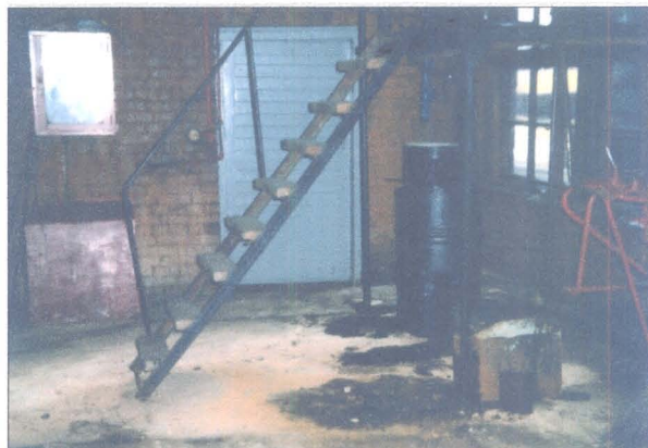
Foto 30. Mõisaküla depoo. Vana vedelkütte katlamaja (2'200 l vaati õlidega, põrand õliga määrdunud)
