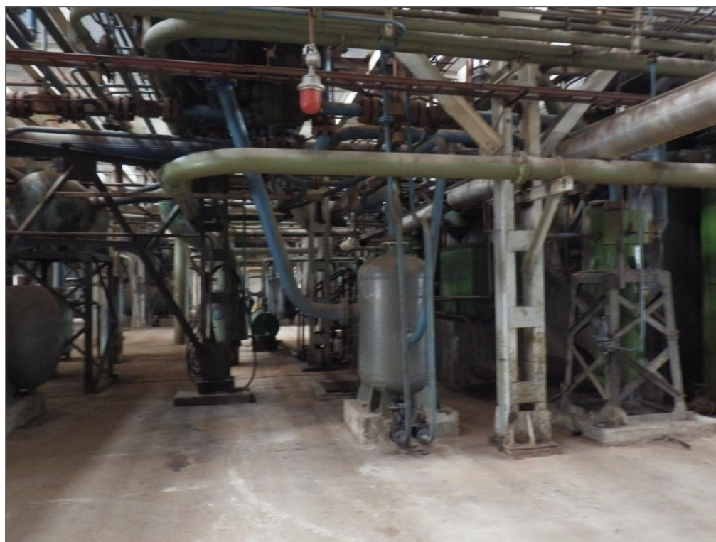
Foto 2 Kompressoriruumi nn keldrikorrus.
