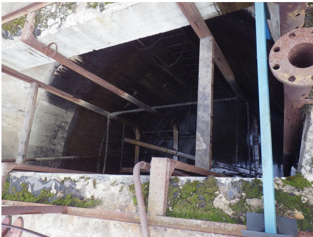
Foto 3 Avatud reservuaar tööstusliku heitvee vastuvõtuks.
