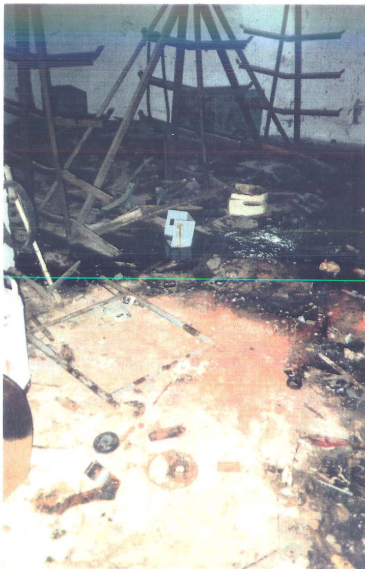
Foto 22. Tundmatud kemikaalid ja õlireostus endises laohoones (objekt nr. 24)
