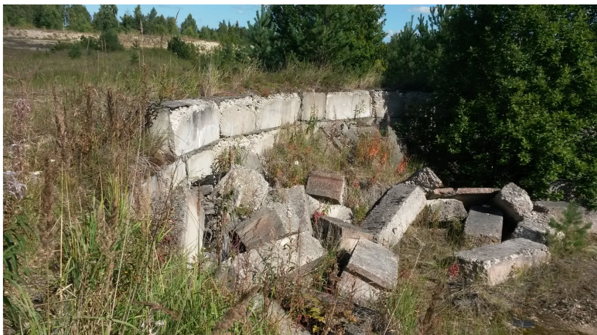
Foto 5. Ümmargune mahutialus. Ringikujuline betoonplokkidest müür. Kokku kaks lagunenu mahutialust müüri.
