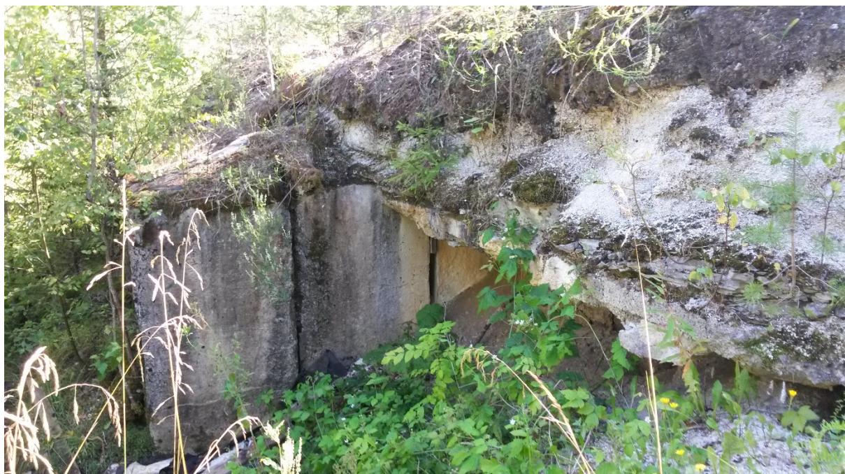
Foto 9. Segusõlme alused betoonelementidest kanal.
