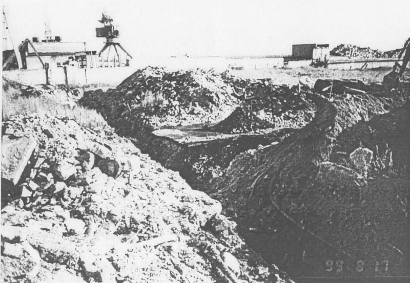
Foto 6. Maa-alt väljatulnud mahutite metallpõhjad ja tugevdus - metallreelsid.
