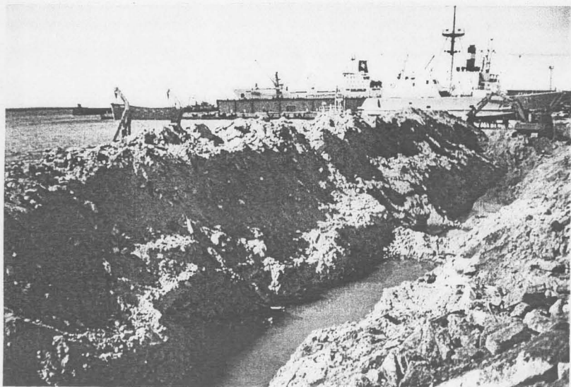
Foto 46. Tranšee nr. 5 loodeosas pumpamistööd ei teostatud, et vaba õli, mis on koondunud sama tranšee kaguossa, ei kanduks laiali.
