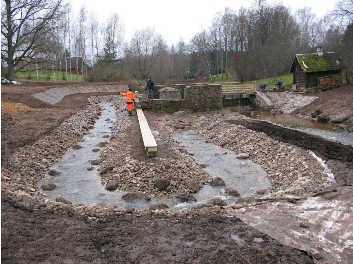
Foto 3. Vaade kalapääsu keskmisele osale. Loodusliku kärestiku ilmega kalapääs pakub pääsus liikuvatele kaladele ka varjepaiku. (M. Kesler 30.11.2015)
