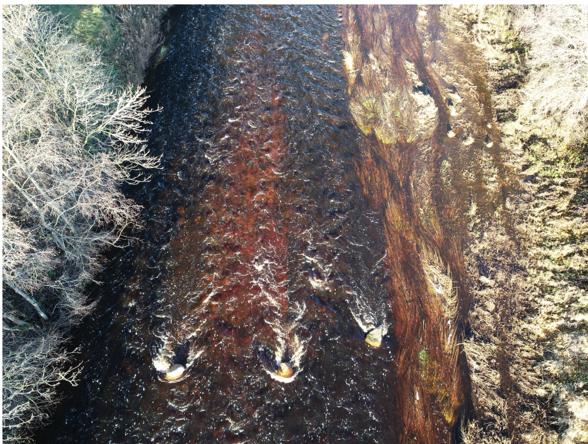
Foto 3.8.1. Parendustööde käigus ehitatud koelmukoht (Joonis 2, koelmukoht nr 7) Pirita jõe Veneküla lõigul 16.12.2020. Jõelõigu mosaiiksuse suurendamiseks ja veevoolu rahustamiseks on jõkke paigutatud ka suuri kive (Foto: Martin Kesler).
