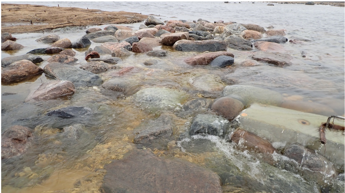
Foto 3.6.9. Regulaatori betoonkehandiga vahetult piirnev pinnasvalli harja kõrgus on madalam kui regulaatori ülemine äär ning seetõttu toimub paisutuse ajal regulaatori külgedel intensiivne veevool, mis omakorda kannab sealt minema täitepinnast ning vähendab efektiivset valli kõrgust veelgi. Vajalik oleks pinnasvalli harja tõstmine regulaatoriga külgnevates lõikudes. (Foto: Roland Svirgsden 29.03.21)
