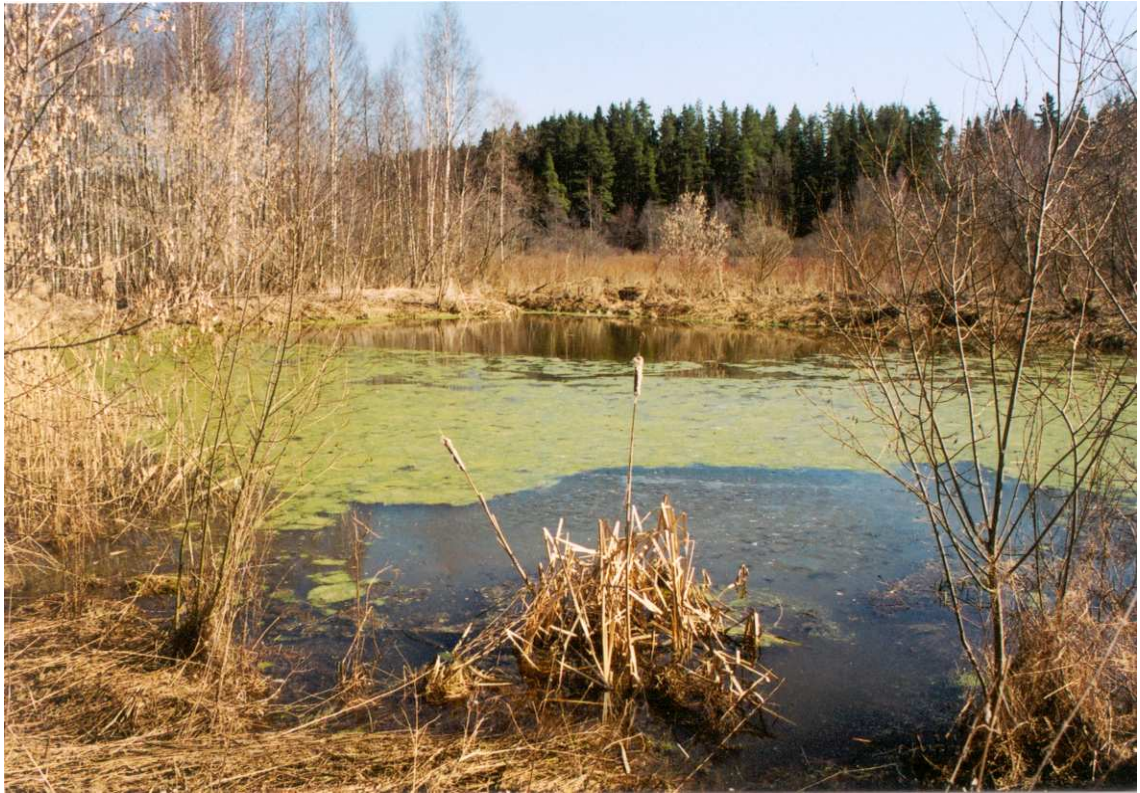
Foto 13. Leevaku asula reovete puhastustiigid on kobraste poolt läbi uuristatud ja sissevoolu trass on umbes ja reovesi jõua ülemise sisevoolu tiigini vaid imbud kopra urgude kaudu alumisse tiiki ja sealt edasi kraavi kaudu jõkke.
